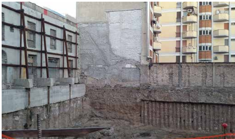
Fig.2 Vista della voragine nello scavo di Sabelli Trading, al posto delle Ex Fonderie Bastianelli in via dei Sabelli.
